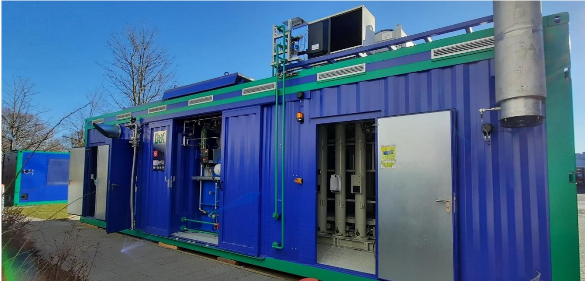
Abbildung 3: Anlage zur Produktion von 100 kg Wasserstoff aus Biogas pro Tag [6].
