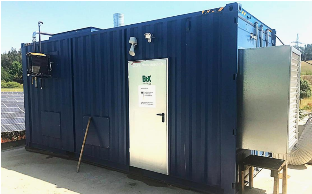
Abbildung 4.25: Containeranlage mit Belüftung, Horn und Fackel
