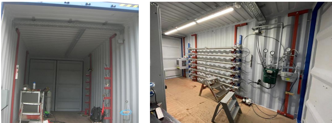
Abbildung 4.18: Ansichten des Abscheidecontainers während der Fertigstellung. Links: Leerer, angepasster Container mit Aufhängungen für die Abscheidermodule, Rechts: Container kurz vor der Fertigstellung mit Sicht auf die Sechs Abscheidermodule.
