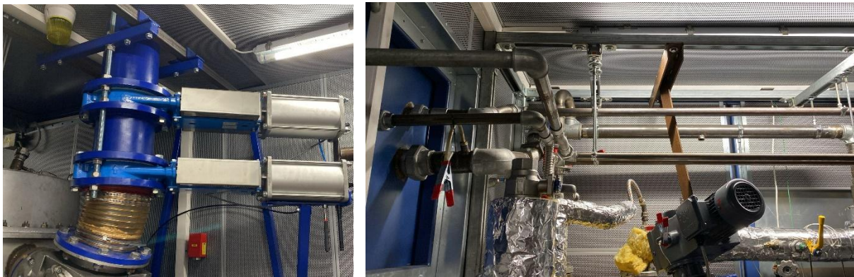
Abbildung 4.24: Abgestütztes Eintrags- und Rohrleitungssystem
