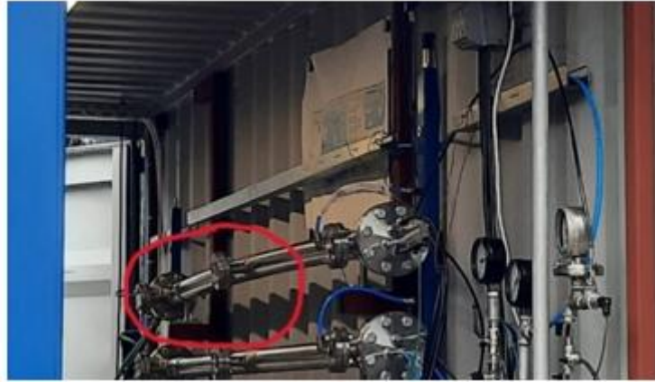
Abbildung 4.22: Ansicht des ersten Moduls nach Abschluss der 2. Versuchsreihe mit Hervorhebung des verformten Bereichs.
