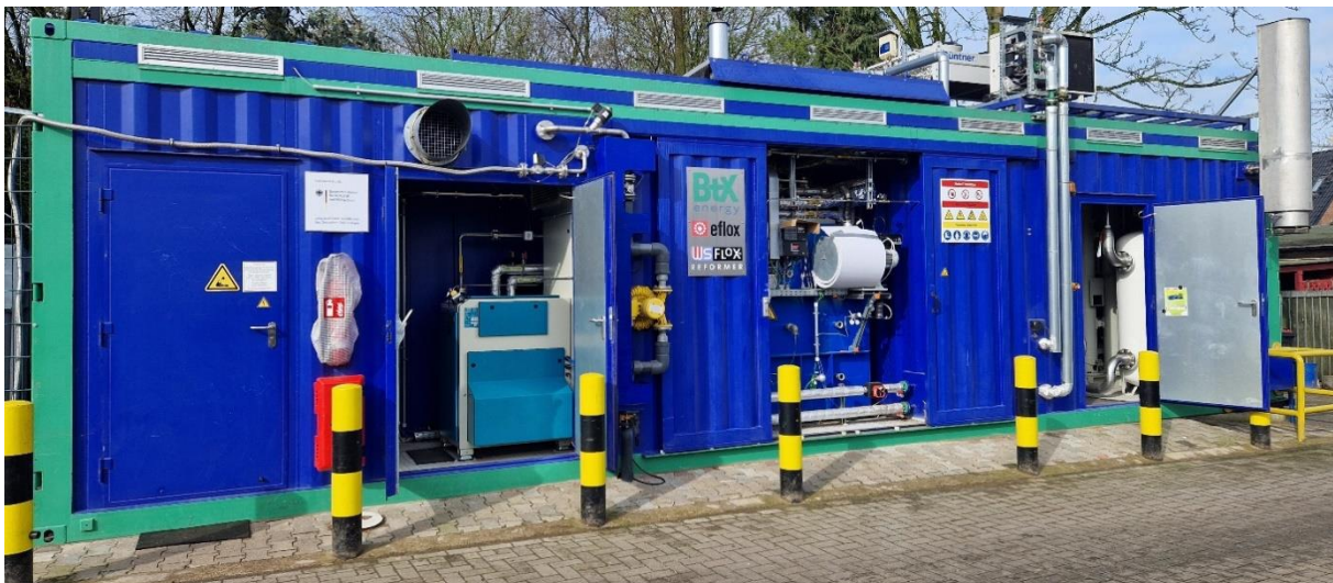
Abbildung 4.1: Reformier-Container mit Anfahrschutzsäulen
